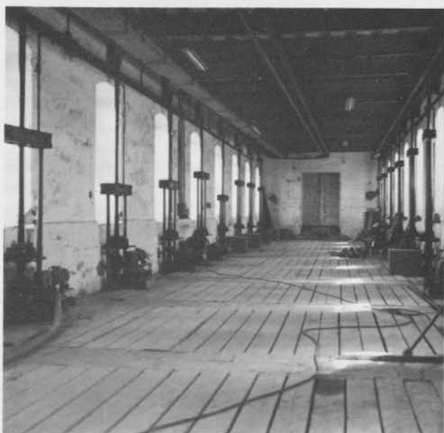
Interior de la casa de compuertas El Bocal
